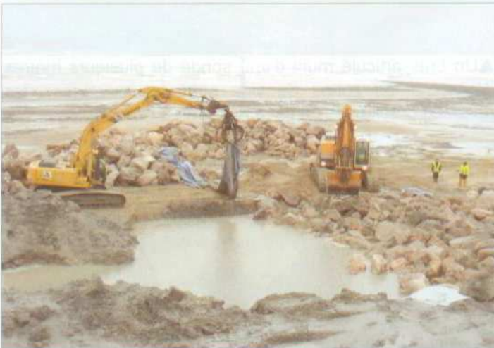
▲Une équipe pose des bandes de feutre géotextile pour stabiliser le sol, très sableux et vaseux. Les bandes sont recouvertes de roches tassées par la pelleteuse. Au premier plan on constate en effet une vase importante...
