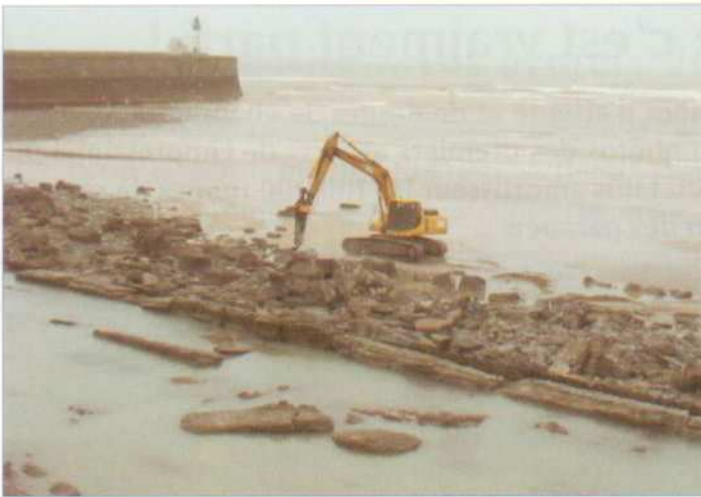
▲Une pelleteuse avec marteau-piqueur casse tous les gros blocs déjà présents sur le site afin d'assurer au futur ouvrage une base propre. Au premier plan, les restes d'une vieille digue aux contours assez compliqués. Le site est nettoyé, les vieux pieux en bois sont enlevés...
