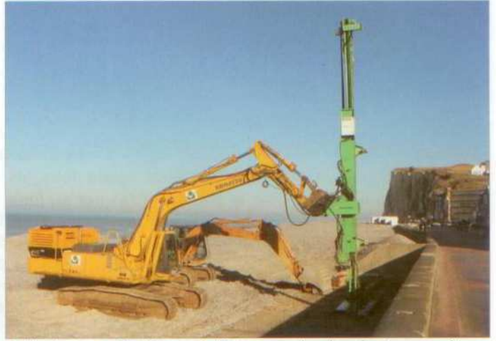
▲ Un bras articulé muni d'une sonde de plusieurs mètres détermine les zones de vide sous les ouvrages, des données précieuses : il n'y a pas droit à l'erreur...
