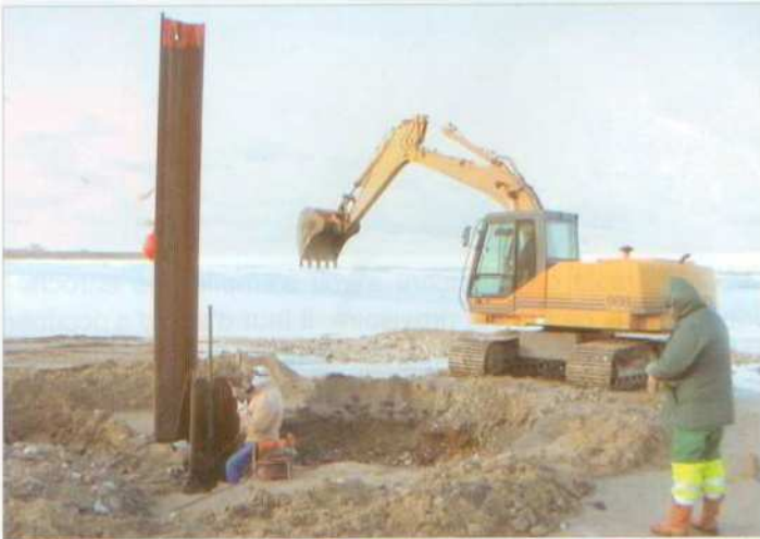
▲ Premiers frémissements : la pose de palplanches et de témoins pour tester la tenue et la stabilité du sol (pour les futurs épis 7a et 7b face au " Bellevue ")...
