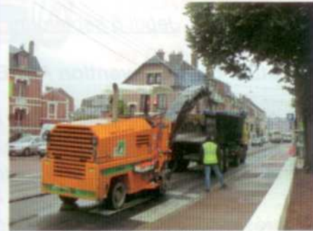
Re-profilage partiel de l'avenue Pierre et Marie Curie (juin 2002). Des travaux remontant pour certains à 1994, et mal exécutés, avaient fortement endommagé cette voirie.
