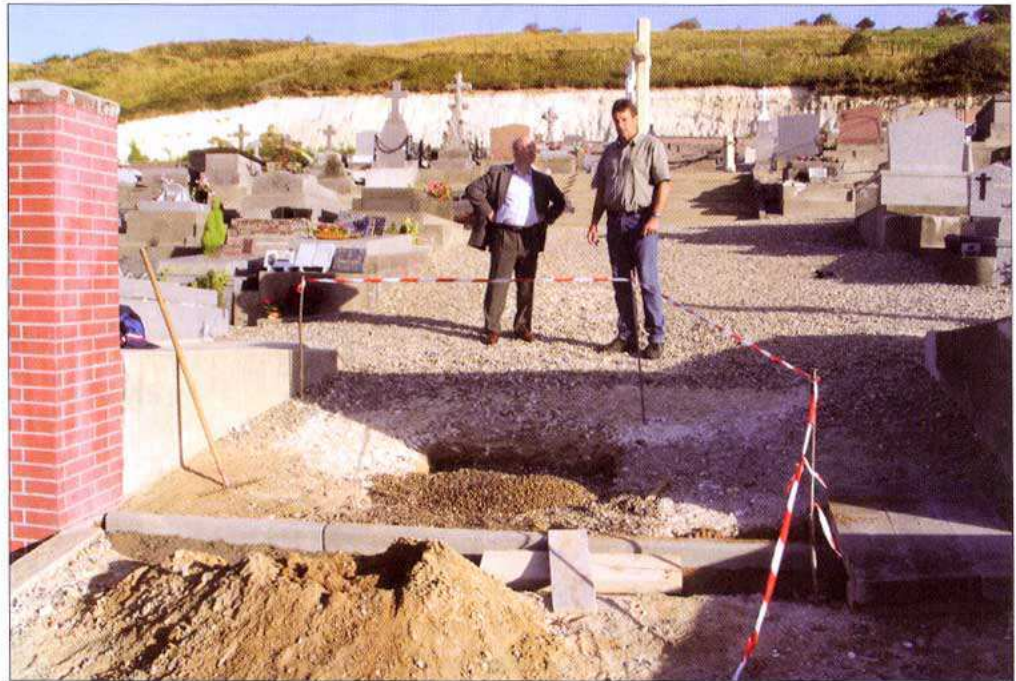
Des puisards comblés de graviers pour la porosité vont capter les eaux de pluie...
