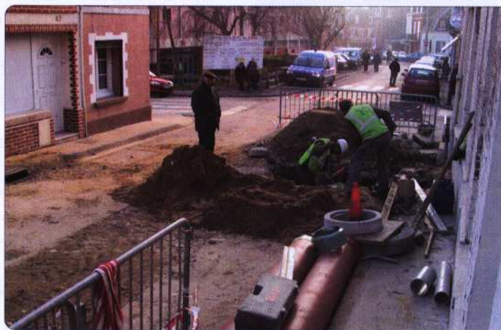
Des collecteurs pluviaux sur des tuyaux de 600 mms seront posés rue Dumont. Trottoirs et enrobés seront refaits...
