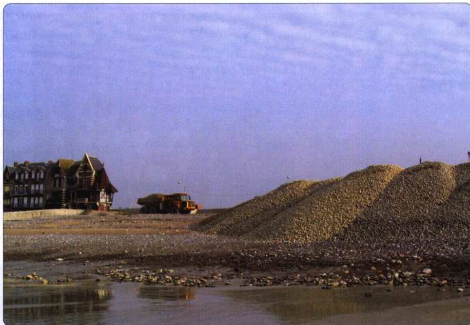
D'un côté des enrochements, de l'autre des apports de galets entre les casiers formés par les épis, le tout pour une protection optimale...
