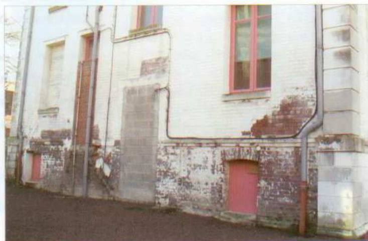
Vue de l'arrière de la mairie. C'est évident, il y a des travaux à faire pour remettre à niveau ce bel édifice...
