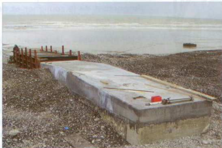
La descente pour les bateaux, en haut de la rue Doumer, fait actuellement l'objet d'un rechemisage en béton jusqu'à sa terminaison dans le sable...
